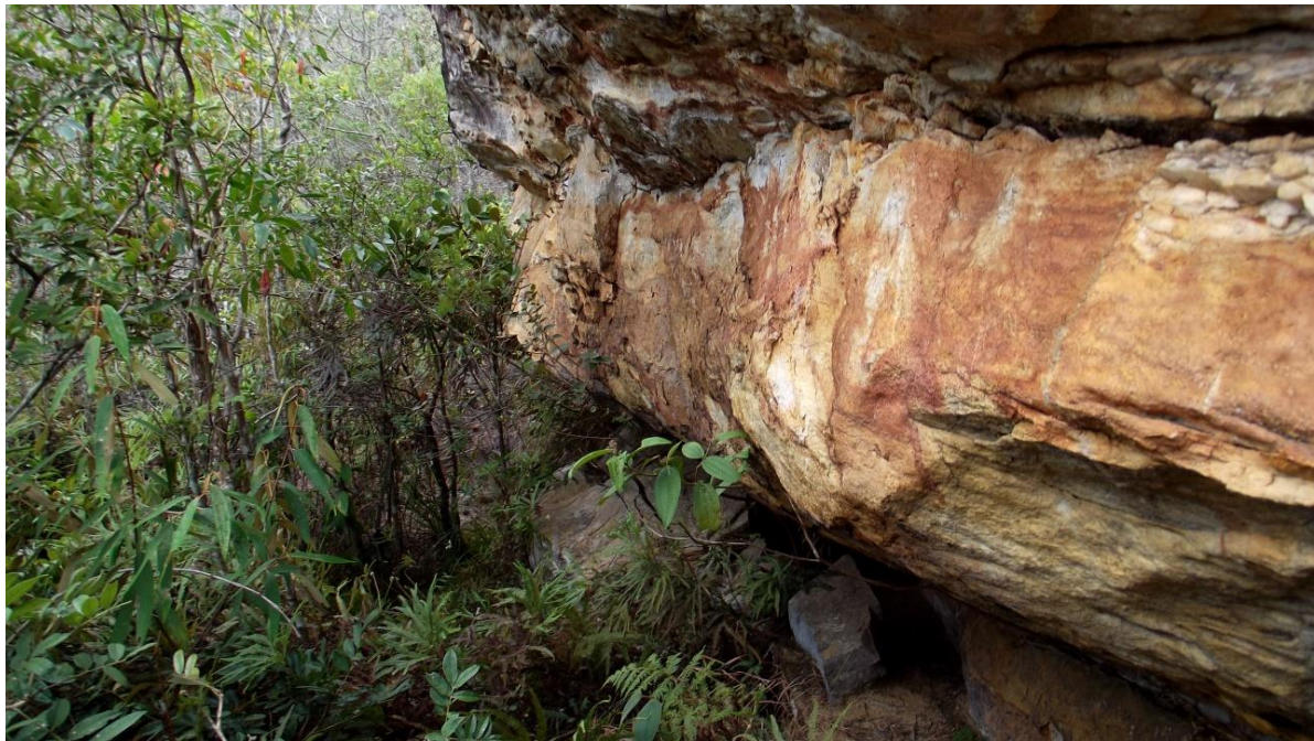
Fotos 2.267 e 2.268: vistas do sítio, com vegetação nativa. Aparente trinca acima do bloco onde estão as pinturas põe em dúvida a segurança do conjunto e inspiram análise e cuidados. Autor: UP, 21/07/2014.
